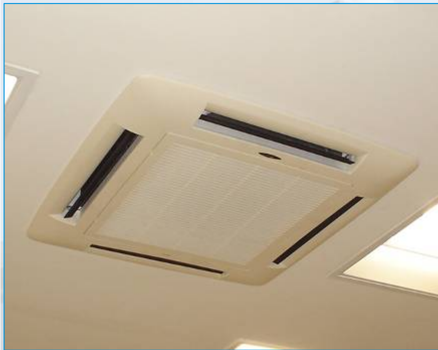
Ar condicionado descentralizado
